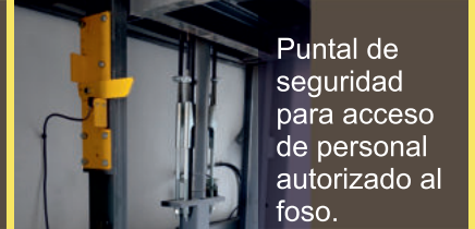
Stop de seguridad en foso.
